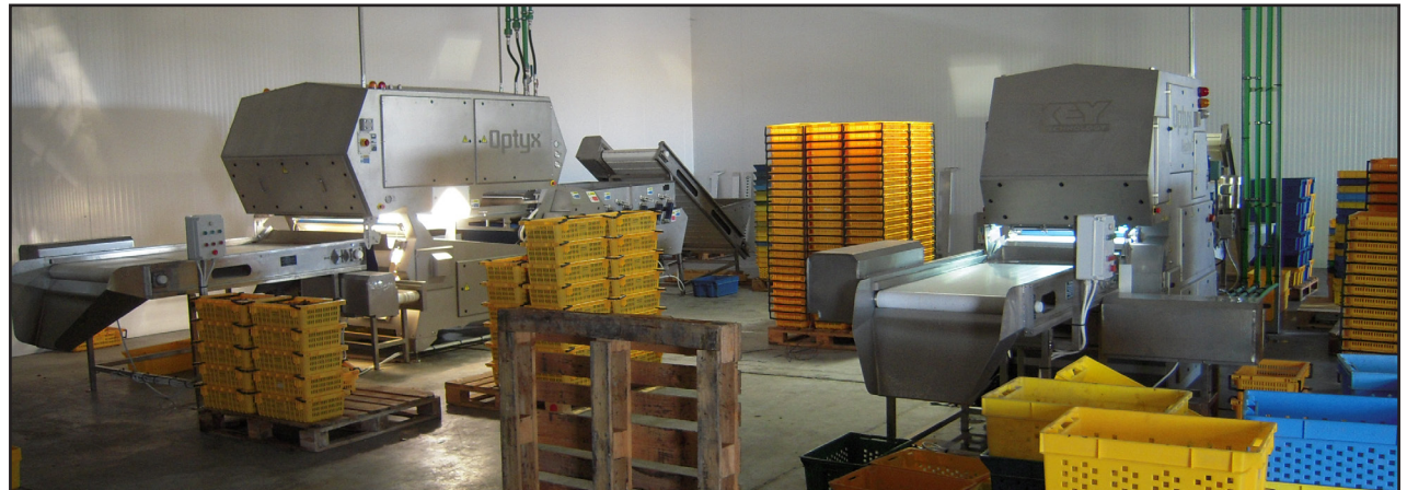
Installation von Optyx® 6000 und Optyx® 3000 Sortierern in einem Dattelverarbeitungsbetrieb
