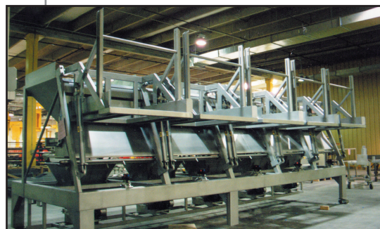
Déversoir de contenant
